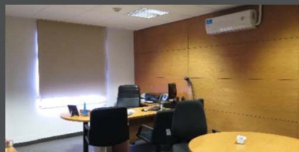
AIRE ACONDICIONADO CENTRAL + SPLITS
